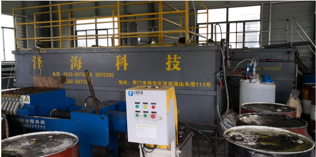
废皂化液处理装置照片
